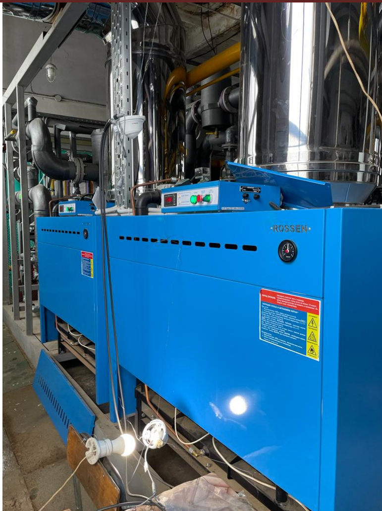
Рисунок 10 – Котлы ROSSEN RS-A 500 №1,2 котельная № 3
